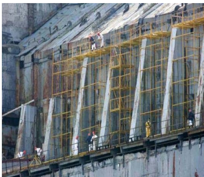
Detalle del Sarcófago. Nótese las manchas de la corrosión. 2006
